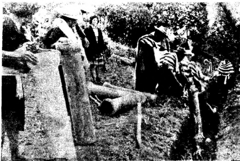
Indígenas Ingás adelantan por acción comunal la construcción de un alcantarillado. (Foto: R. Giacometto).
